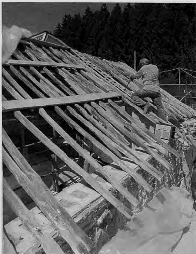
Intervento di manutenzione e consolidamento su una copertura tradizionale nella Comunidad Valenciana.
