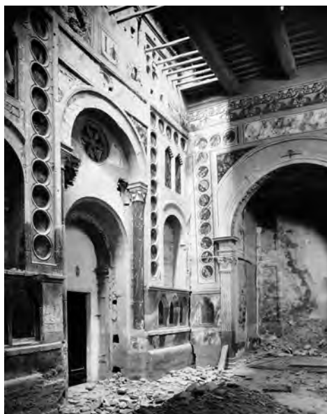
Perugia, la facciata della chiesa di S. Francesco al Prato durante la demolizione della cappella del Gonfalone, 1925 (ASSPg, b. 54 II 5a).
