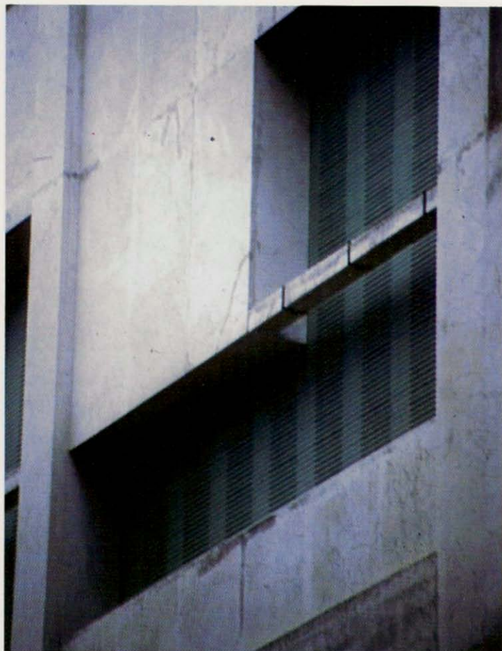
Fig. 3 - Como, Casa del fascio, attuale sede della guardia di finanza (G. Terragni, 1928-1936). Dettaglio del prospetto laterale; si noti l'aspetto variato che ha conservato il rivestimento lapideo dopo l'intervento. L'uso di fascette a sostegno di piccoli tratti di rivestimento costituisce un semplice espediente mutuato dalla prassi sull'antico che consente di riparare il danno conservando il pezzo originale senza turbare l'unità figurativa dell'immagine.
