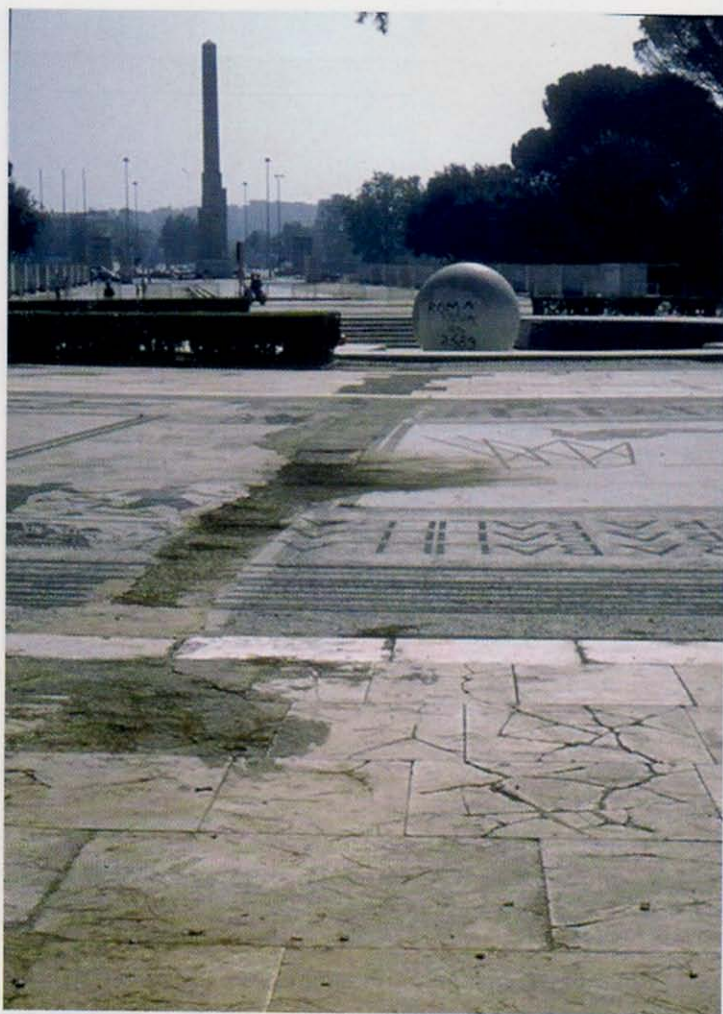
Fig. 5 - Roma, Fontana della Sfera e viale dell'Impero al foro di Mussolini, oggi Foro Italico (rispettivamente di M. Paniconi, G. Pediconi e di L. Moretti, 1933-1934). Lo stato penoso di degrado della pavimentazione nel 1990 prima dell'intervento di restauro (foto C. Varagnoli).
