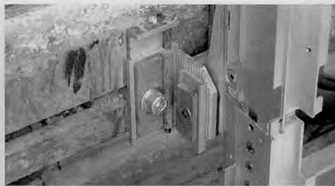
Fig. 7 - Dettaglio di un ancoraggio dei pannelli di facciata rimontato in sede dopo il trattamento in laboratorio; gran parte della vecchia ferramenta è stata recuperata e riutilizzata nel rimontaggio.
