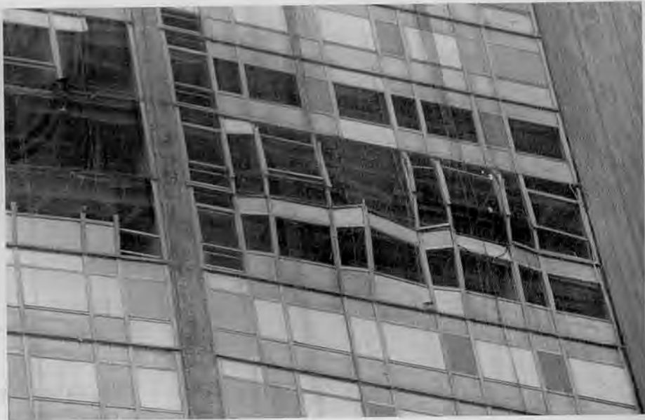
Fig. 5 - Dettaglio di una parte della facciata danneggiata dall'incidente aereo; si nota la particolare deformazione dell'intelaiatura metallica dei serramenti piegata dalla pressione dell'aria fuoriuscita dall'edificio sotto la spinta dell'esplosione del carburante nel velivolo. Il danno, macroscopico in prossimità della zona dell'impatto, è stato rilevato anche in corrispondenza dei piani inferiori e superiori, seppure con minore intensità.
