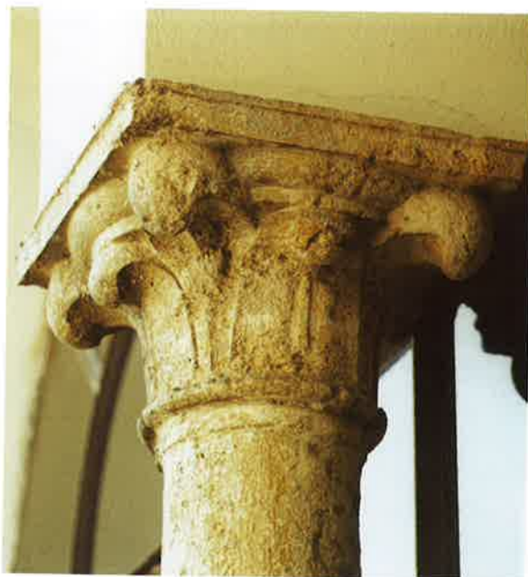
Fig. 37. Capitello delle colonnine che sostengono le arcate del secondo ordine del chiostro. Nessuno degli ottanta capitelli in opera mostra differenze evidenti; al contrario, la loro esecuzione appare fatta in serie, come dimostra anche il ritrovamento di un capitello 'di scorta' dissotterrato nel chiostro durante recenti lavori di restauro.
