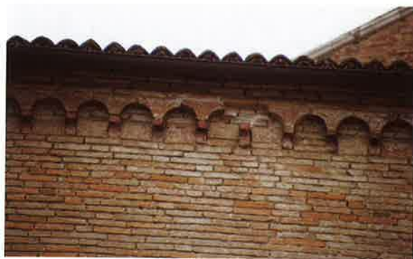
Fig. 9. Particolare della cornice di gronda in cotto su archetti che definisce i bracci del convento risalenti al XIV-XV secolo; essa è stata alterata in seguito al rifacimento delle coperture negli anni Cinquanta, quando l'orditura lignea fu sostituita con una moderna struttura metallica con zampini in cemento armato.
