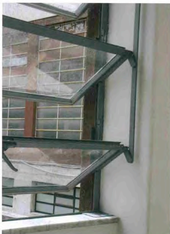
FIGURA 14 • Roma, ex "Casa Gil" a Trastevere. Dettaglio degli infissi delle grandi aperture che illuminano la "galleria degli onori" dopo il recente restauro. Sono bastate la sostituzione delle vetrate, la semplice manutenzione e la verniciatura delle superfici metalliche per restituire agli elementi originali la loro piena funzionalità ed efficienza.
